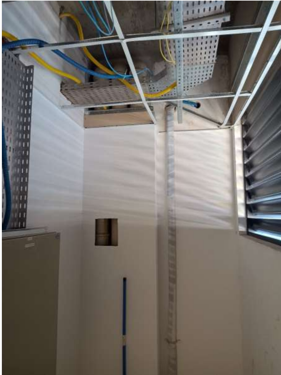
Imagem 3 – Visão geral da área técnica para instalação de condensadoras
